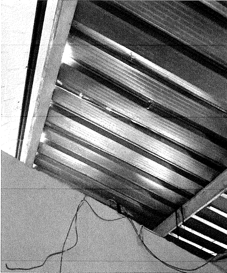
Figura 1 – Telhas a serem trocadas
