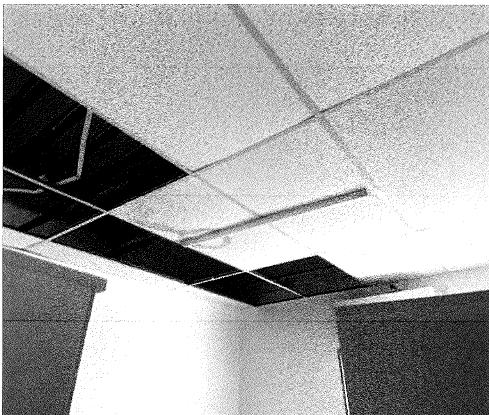
Figura 2 - Forro a ser removido
