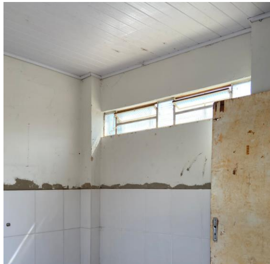
Figura 4-7 – Forro a ser substituído
