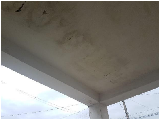
Umidade no teto
