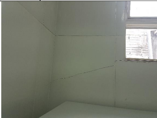
Trinca na Parede
