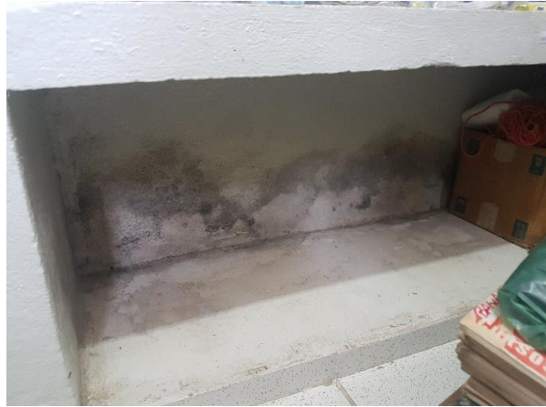
Mofo considerado 0,5 m
