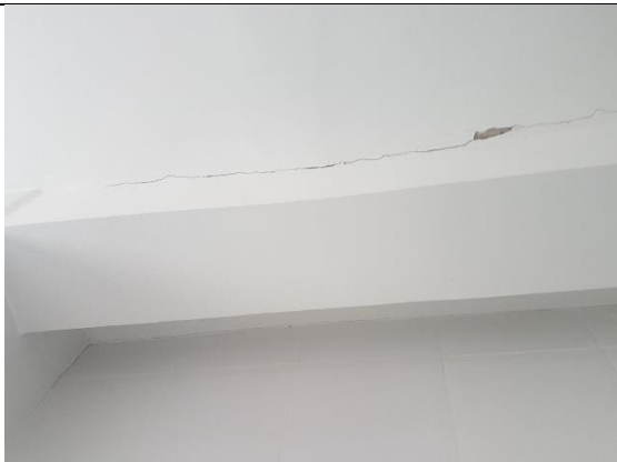
Trinca na viga do banheiro
