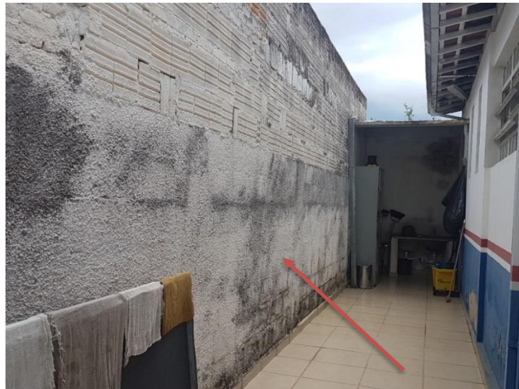
Figura 2 - Parede do corredor 3
