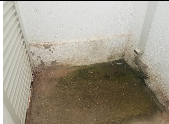
Mofo no chão da Entrada 2
