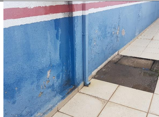
Área sem piso em corredor externo
