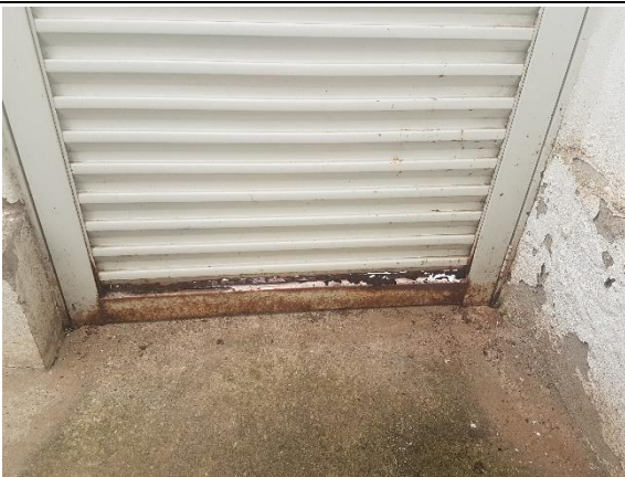
Porta de Metal a ser substituída
