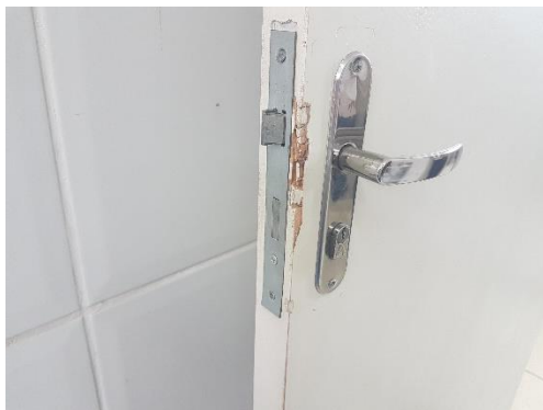
Porta com defeito a ser substituída
