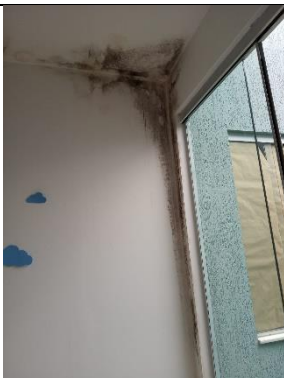
Placas de acartonado a serem trocadas
