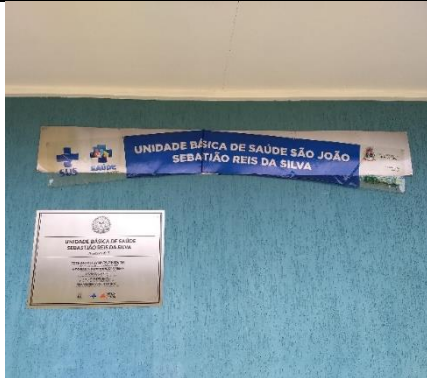
Placa a ser substituída.
