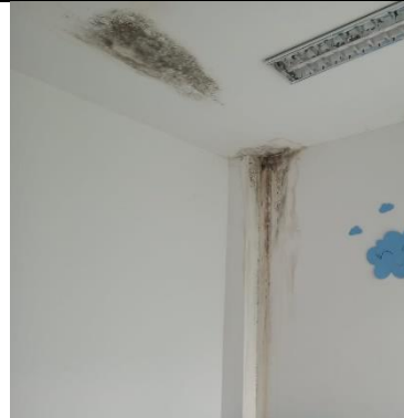
Trocas de forro onde apresentam protuberância
