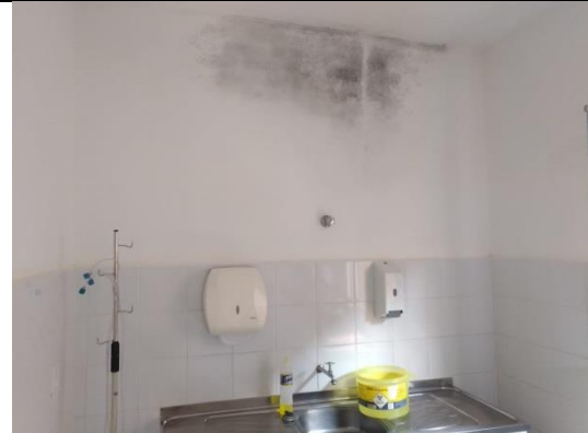
Umidade presente na sala de curativo
