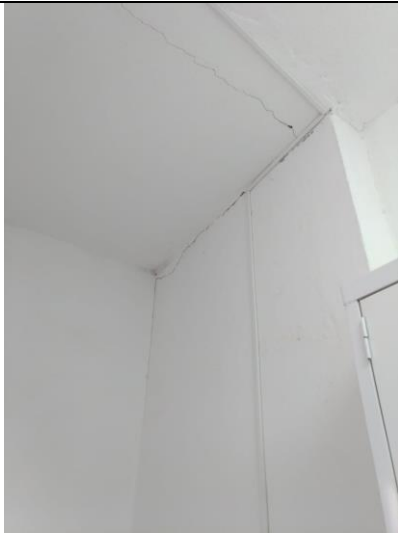
Trinca de junção na cozinha
