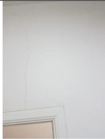
Trinca sobre a porta do consultório geral
