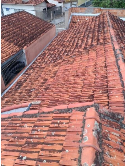
Situação atual do telhado
