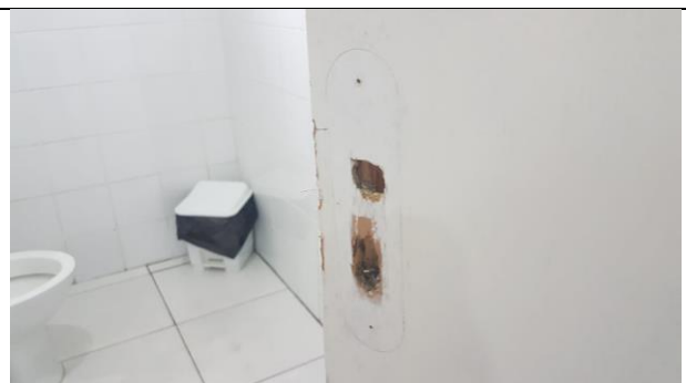
Porta do banheiro masculino sem fechadura
