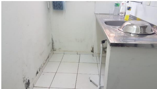
Umidade presente na sala de expurgo
