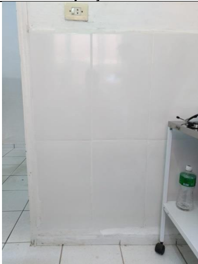
Azulejo existente na sala de triagem
