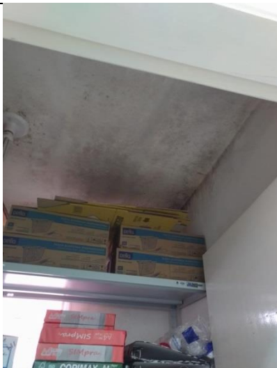
Umidade Presente no teto do almoxarifado
