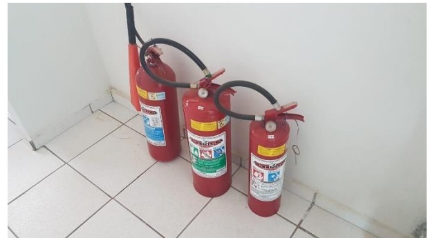
Sistema de combate e prevenção a incêndio irregular
