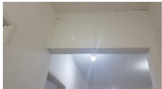
Trinca de junção no corredor
