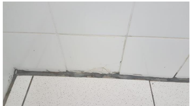
Azulejo quebrado no banheiro feminino
