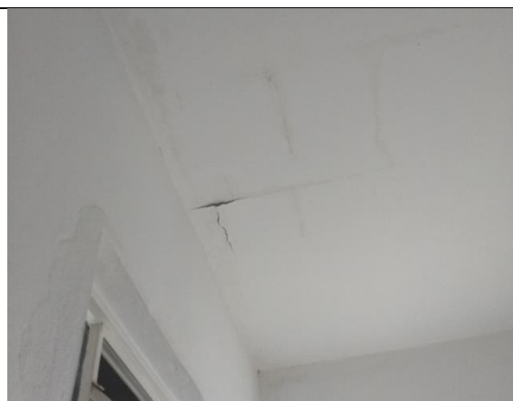
Trinca a ser tratada no corredor do Hall
