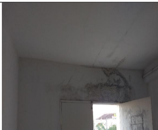
Tratamento a ser feito na parede da recepção
