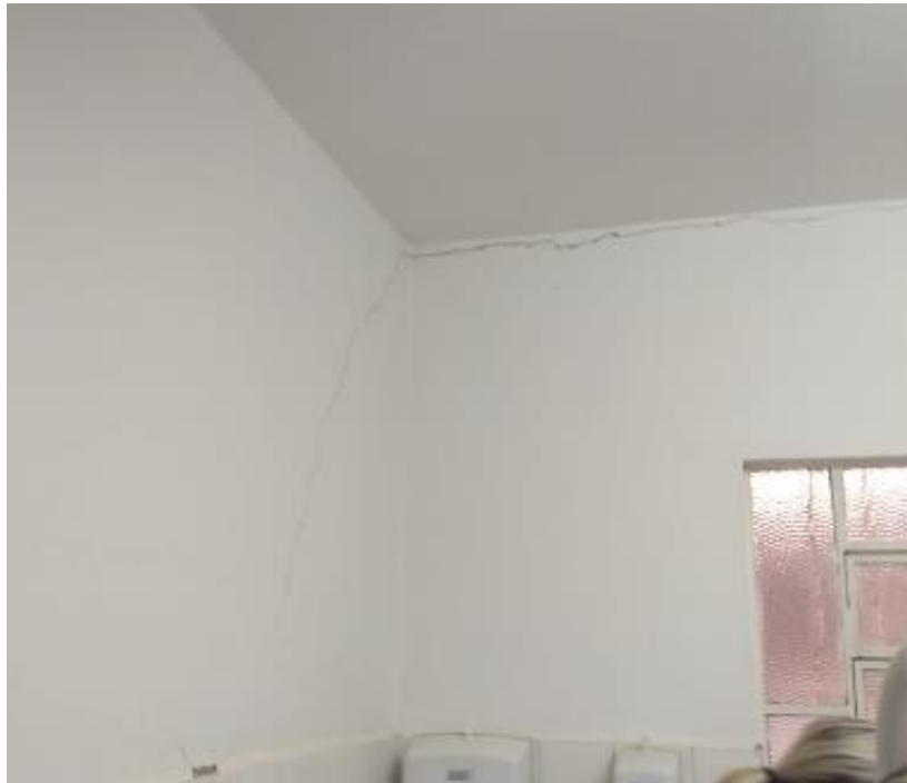
Figura 3 - Identificação da trinca na cozinha.
