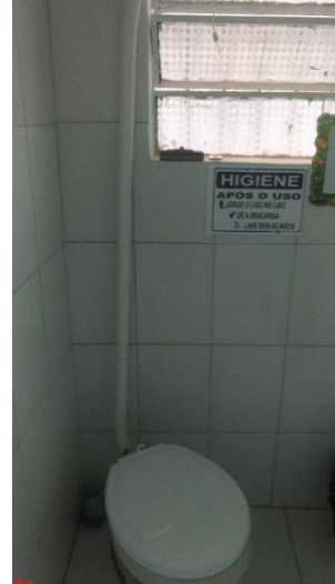
Vaso sanitário a ser trocado
