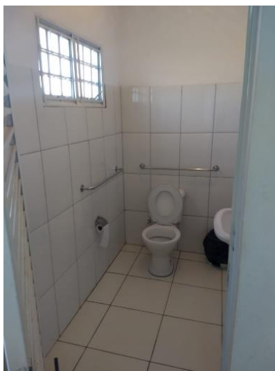
Figura 5 - Banheiro da recepção que deverá receber rejunte
