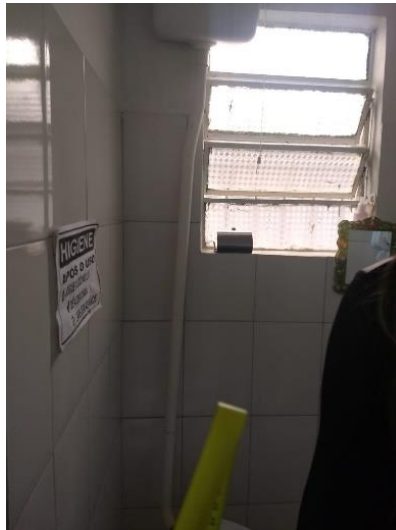
Figura 6 - Azulejo que deverá ser trocado do WC da sala de ginecologia
