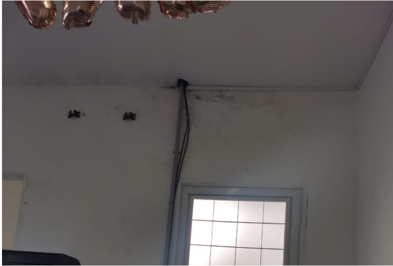
Figura 1 - Parede que deverá receber tratamento
