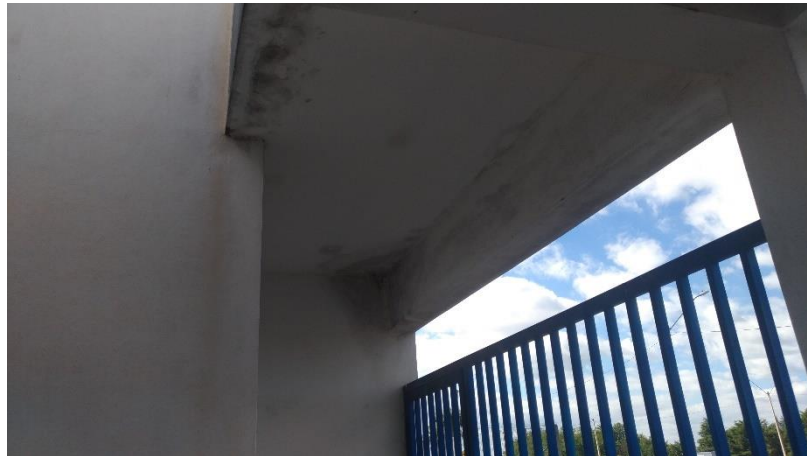
Figura 2 - Teto que deverá receber tratamento
