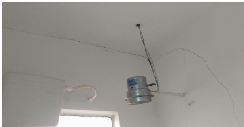
Figura 4 - Identificação da trinca no WC.
