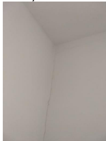
Trinca a ser tratada
