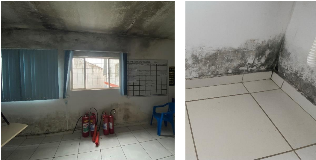
Figura 4-7 – Locais com infiltração
