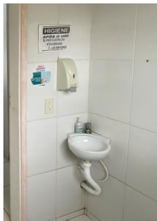
Figura 4-10 – Lavatório de canto
