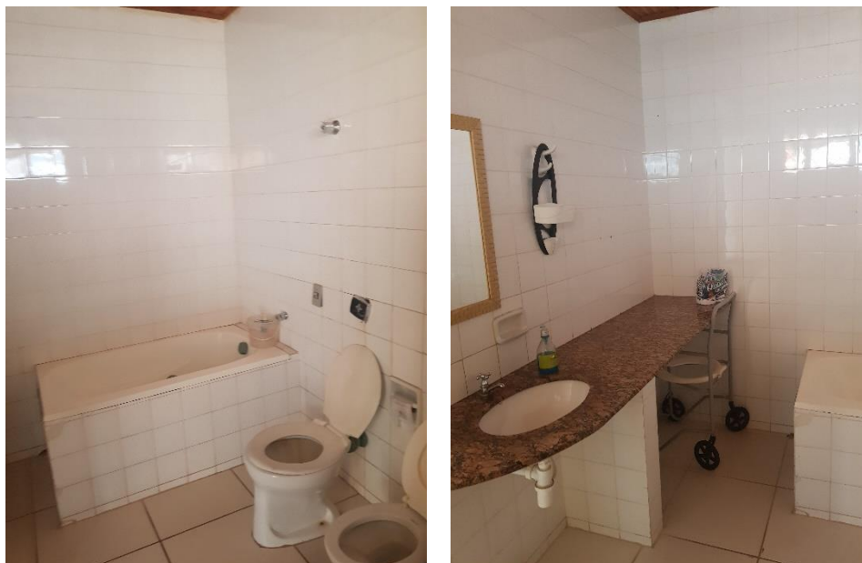
Figura 14 - Banheiro Feminino Atual
