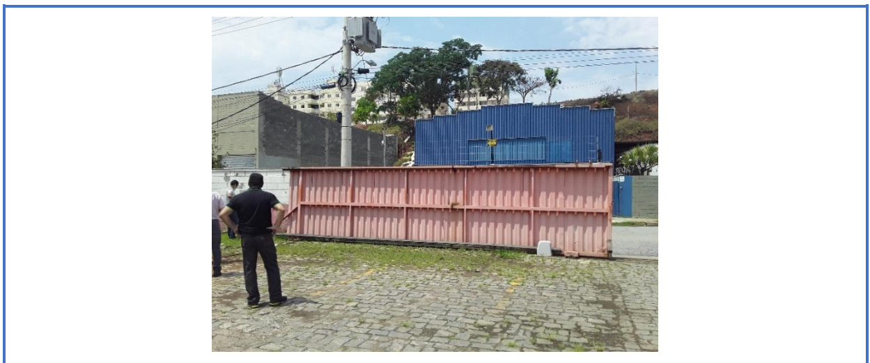
Figura 9 – Portão a ser removido e reaproveitado
