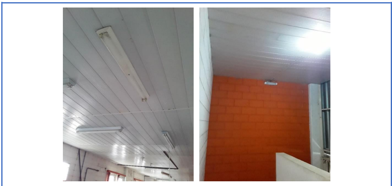
Figura 7 – Forro de PVC a ser removido
