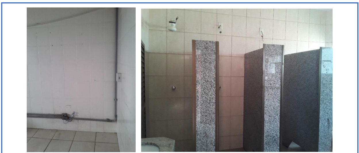
Figura 3 – Revestimento cerâmico a ser removido
