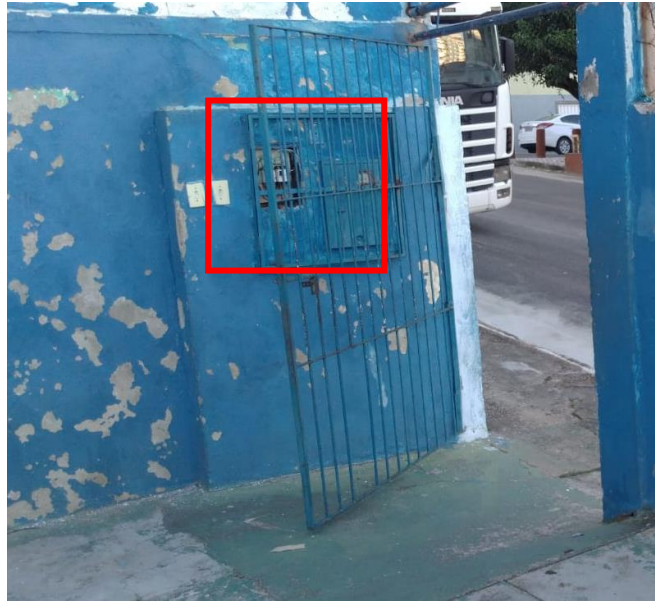
Figura 2-6 – Quadro de distribuição a ser substituído.
