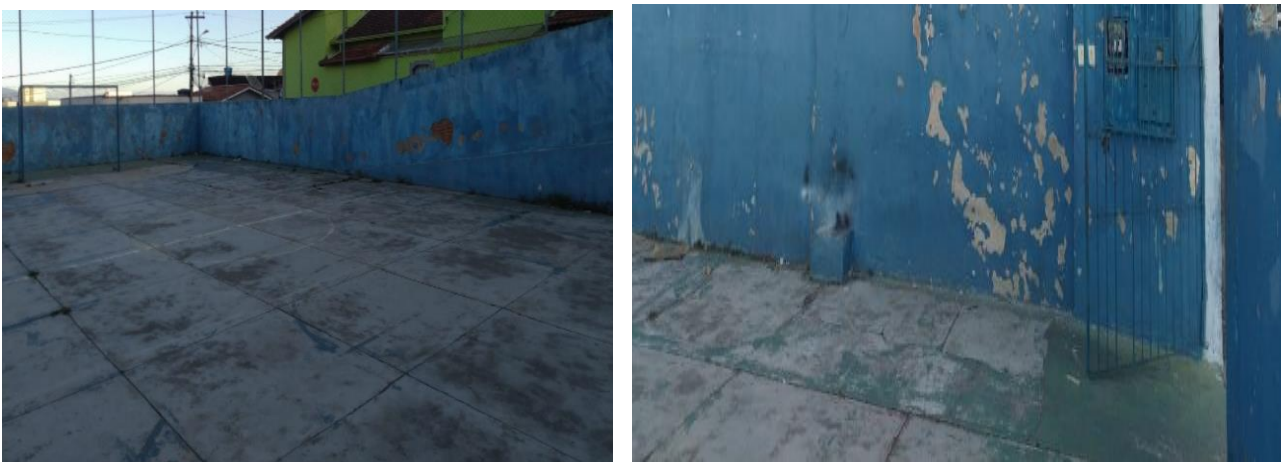
Figura 2-4 – Condições do piso da quadra
