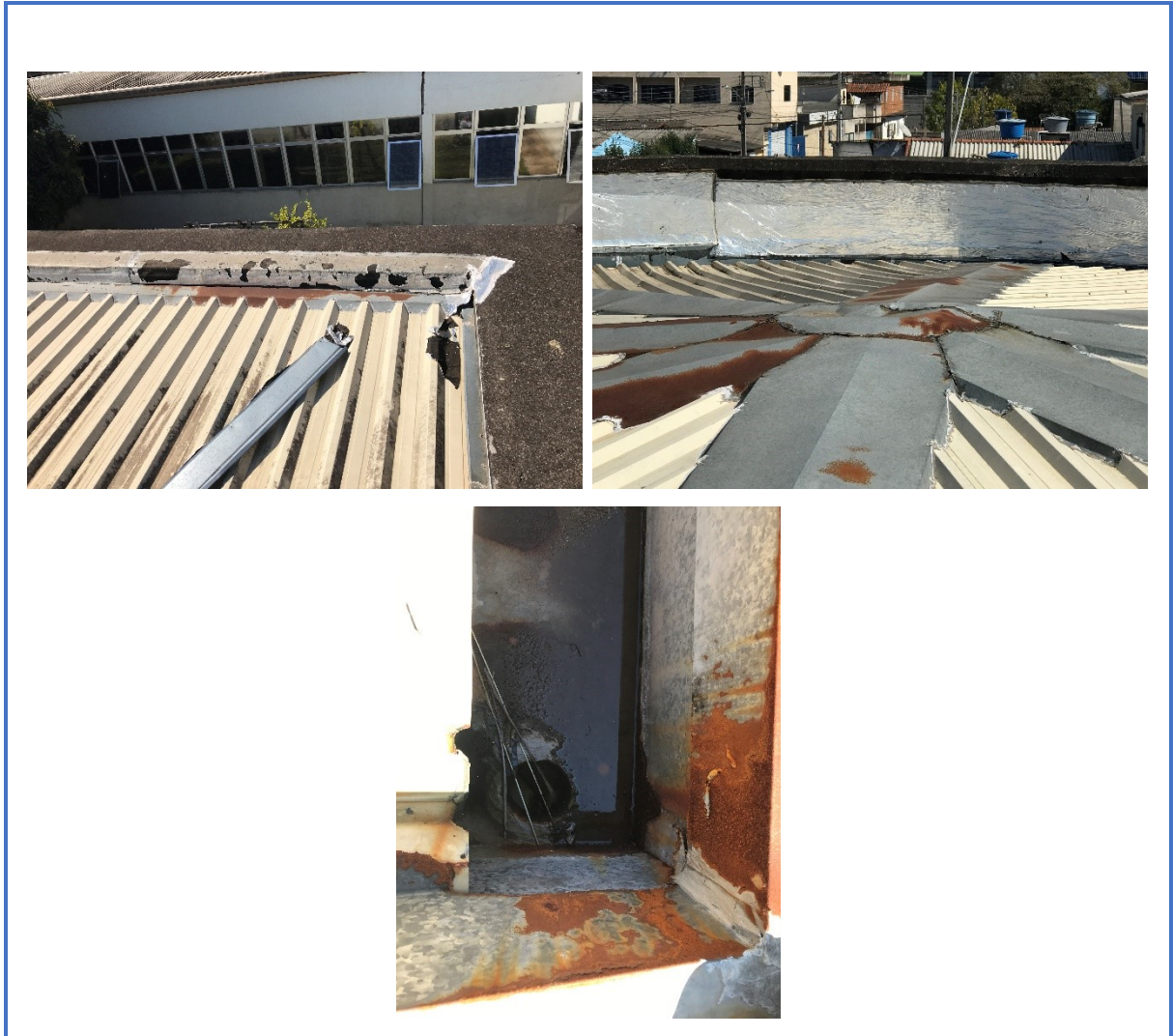
Figura 3 – Calhas, Rufos e Chapins Danificados
