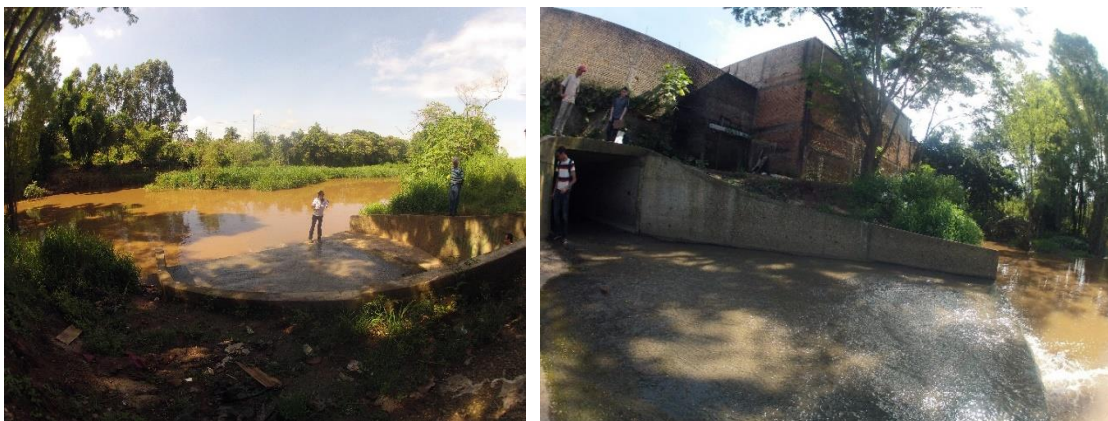
Figura 3.1 - Descarte da rede de drenagem no Rio Sapucaí Mirim
