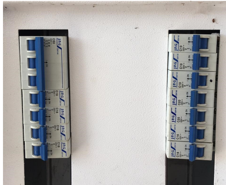
Figura 18 - Quadro de Distribuição (QD3)
