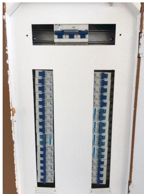
Figura 15 - Quadro de Distribuição (QD1)
