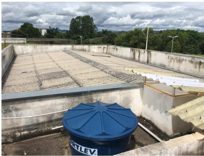
Figura 5 - Caixa d'Água Bloco 01
