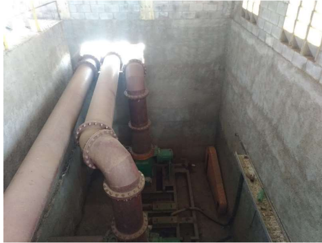
Figura 20-1- Bombas e Tubulações Fonte: DAC Engenharia
