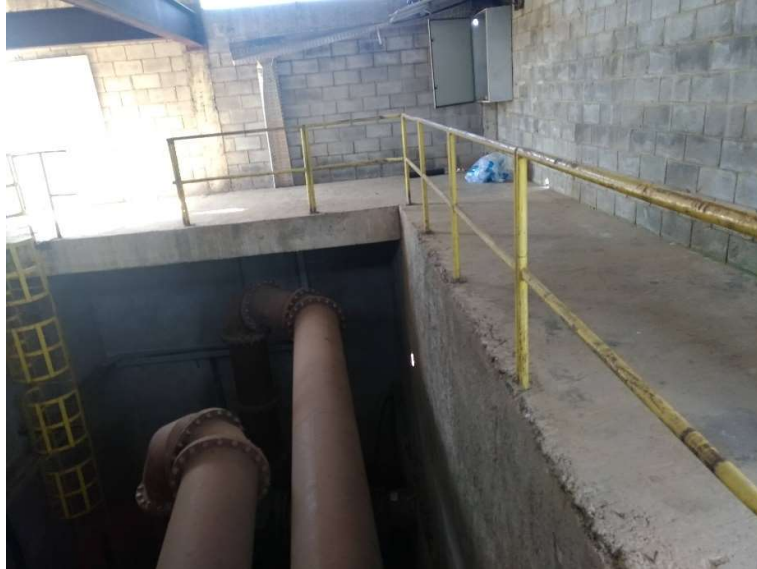
Figura 8-3 - Área interna da casa de máquinas
