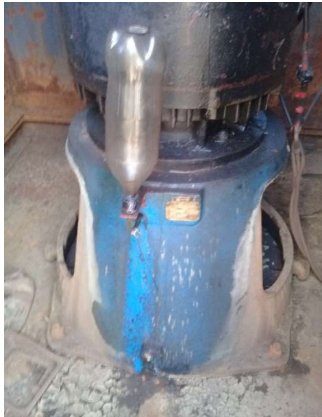
Figura 10 - Falta de reservatório adequado para lubrificação
