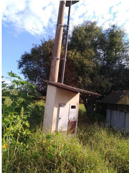
Figura 5 - Estrutura da casa de painéis - DIQUE 01
