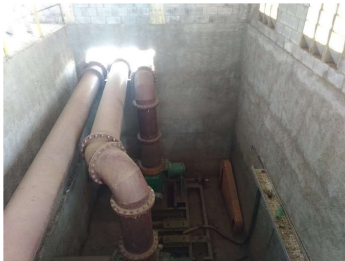
Figura 44 - Bombas e tubulações - DIQUE 02
