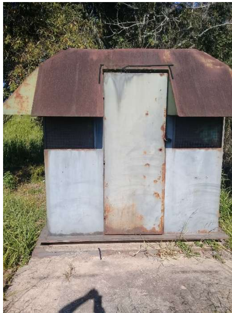
Figura 9 - Casa de comando e acionamento
