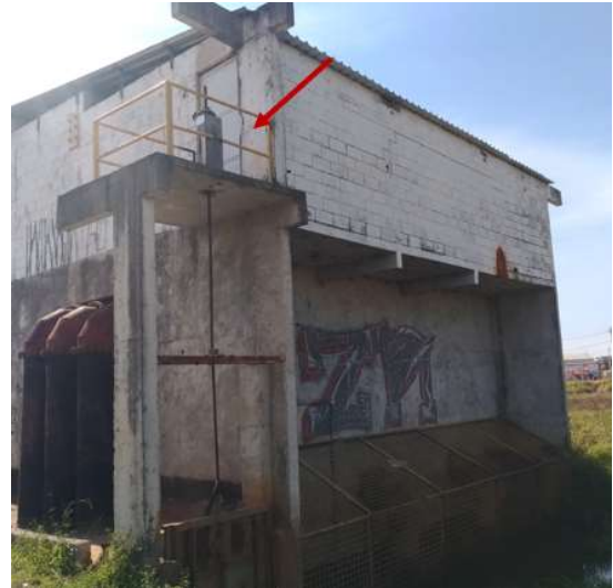
Figura 31 - Porte de acesso ao controle da comporta -DIQUE 02
