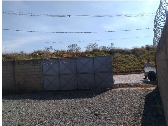
Figura 47 – Perímetro de concertina a ser trocada – DIQUE 02
