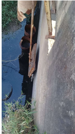
Figura 20 - Tubos que devem receber o arremate - DIQUE 01
