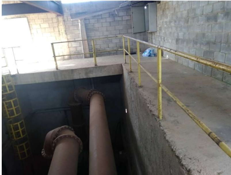
Figura 27 - Área interna da casa de máquinas - DIQUE 02
