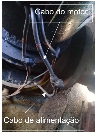
Figura 14 - Diâmetro diferente de cabos entre motor e cabo de alimentação
