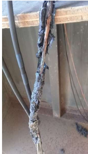
Figura 11 - Cabos de alimentação da chave de partida carbonizado
