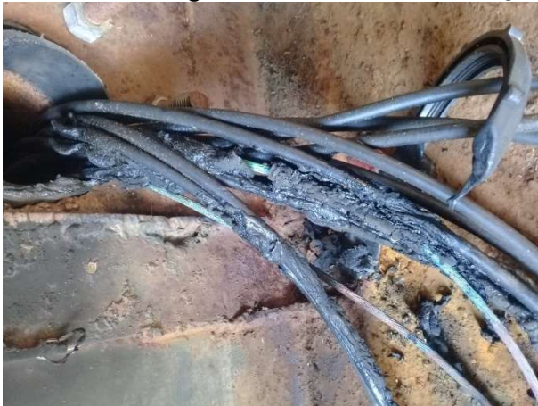
Figura 12 - Cabos de alimentação dos motores
