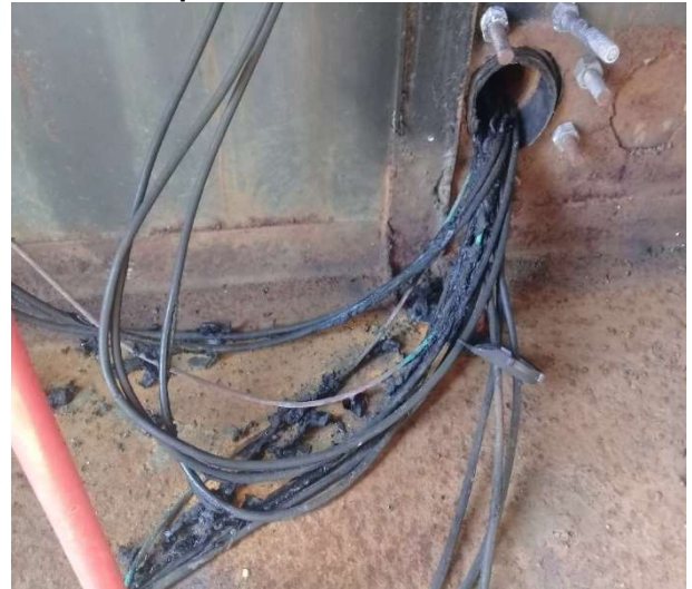
Figura 13 - Cabos de entrada e saída passando pelo mesmo ponto
