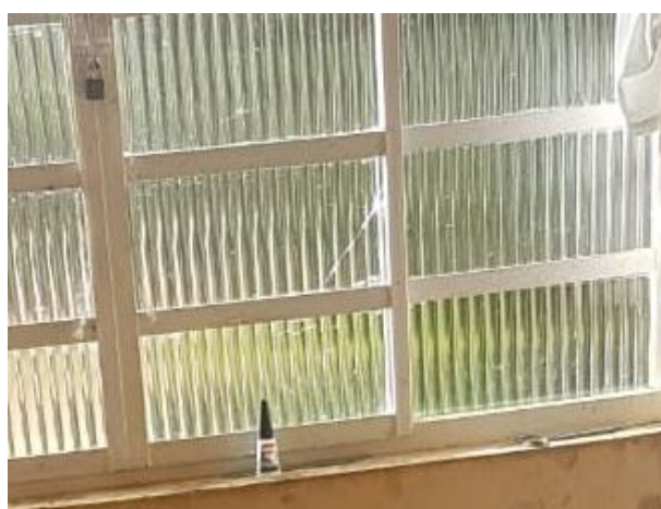
Figura 4 - Exemplo de vidro trincado
