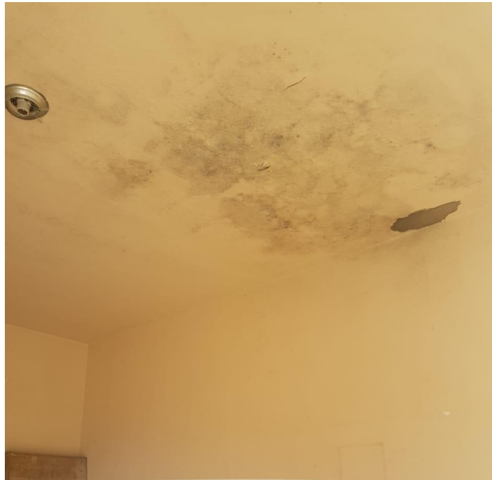
Figura 1 - Local com umidade no teto
