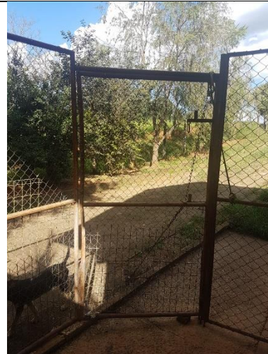
ALAMBRADO DE SEGURANÇA A SER TROCADO
