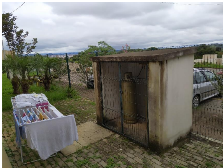
Figura 4 – Casa de Gás
