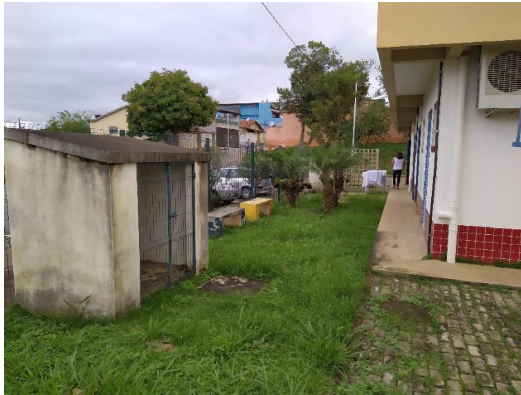
Figura 3 – Casa de Bombas e Bancos
