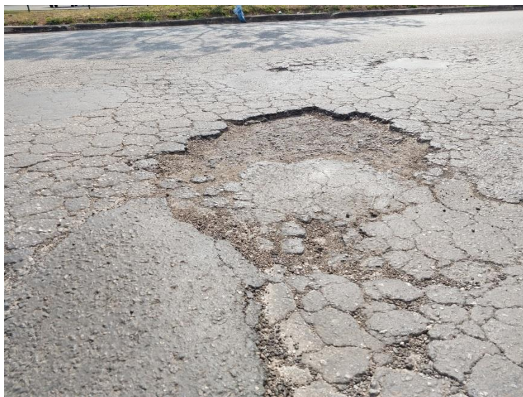
Figura 5 - Desprendimento da pavimentação asfáltica da via.
