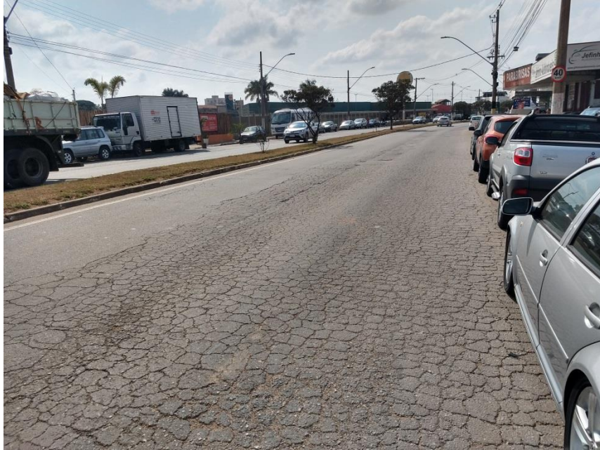
Figura 3 - Trinças tipo "couro de jacaré" oriundas da fadiga de pavimento
