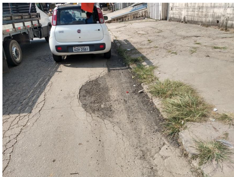
Figura 4 - Erosão no bordo da pista de rolamento.
