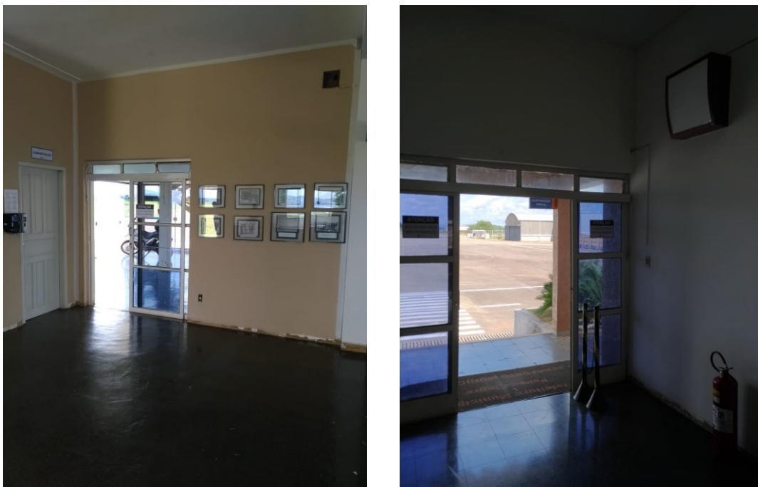
Figura 16 – Portas a serem substituídas
