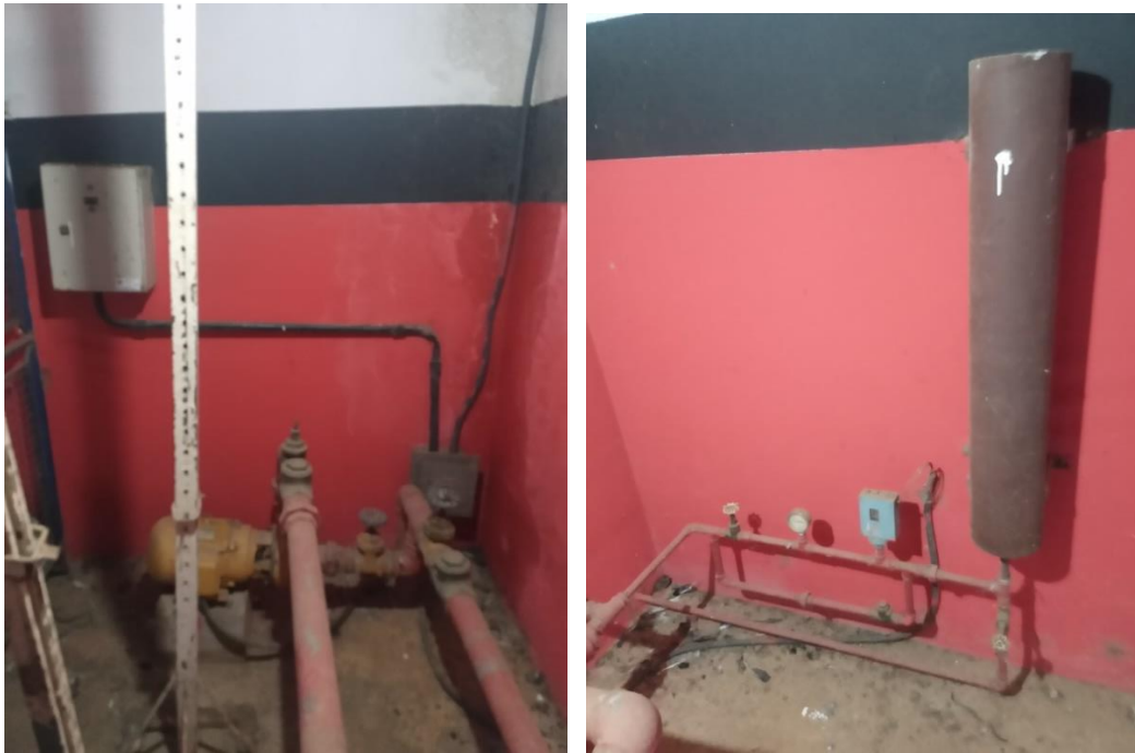
Figura 6-23 – Casa de máquinas
