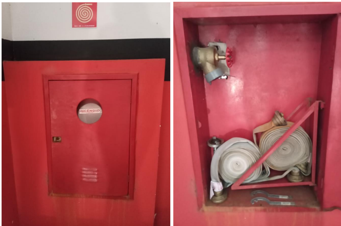
Figura 6-10 – Hidrante Vestiário I
