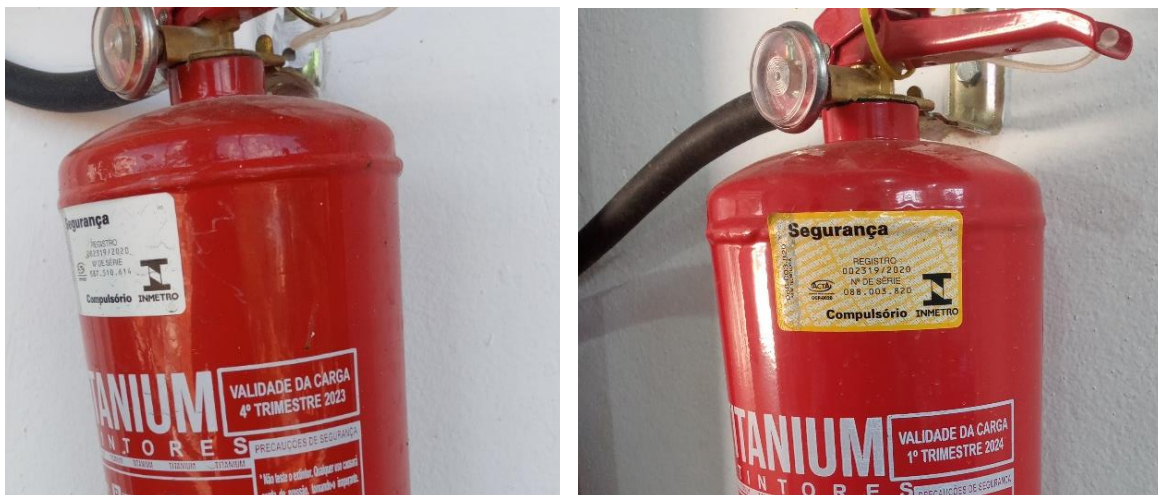
Figura 6-6 – Validade da carga dos extintores
