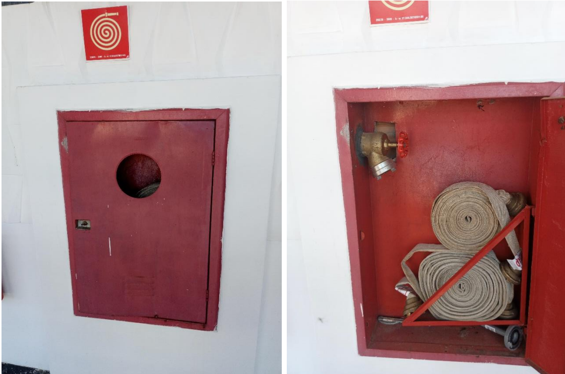
Figura 6-21 – Hidrante Superior I
