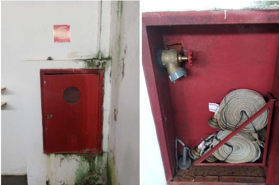
Figura 6-17 – Hidrante do caixa da Lanchonete II
