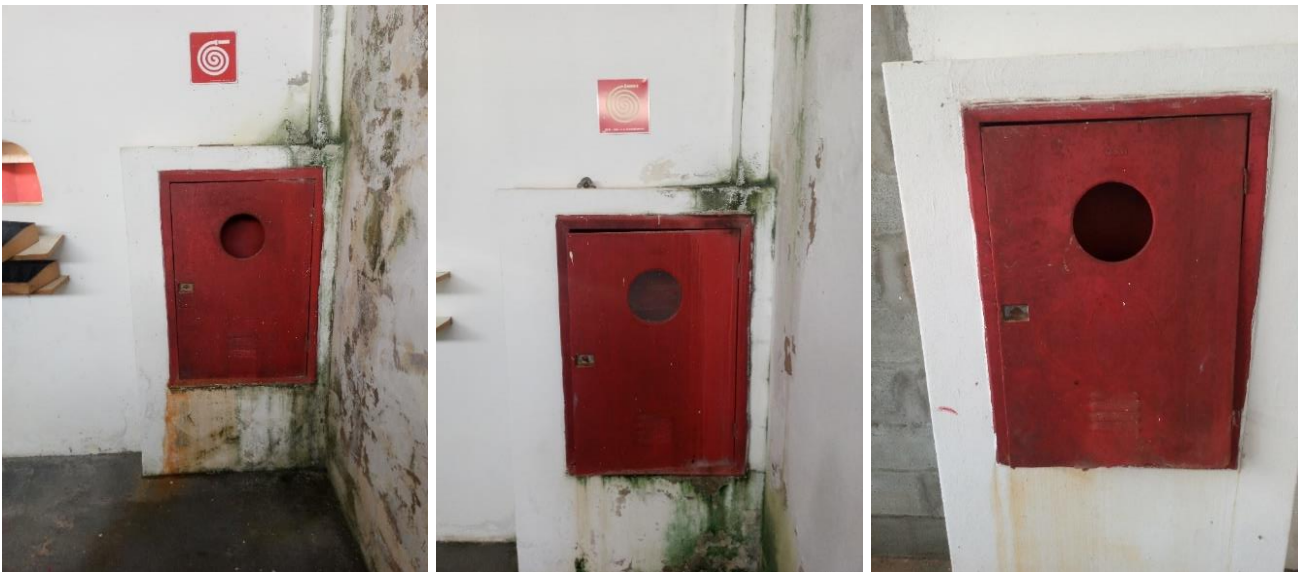
Figura 5-1 – Revestimentos que apresentam umidade
