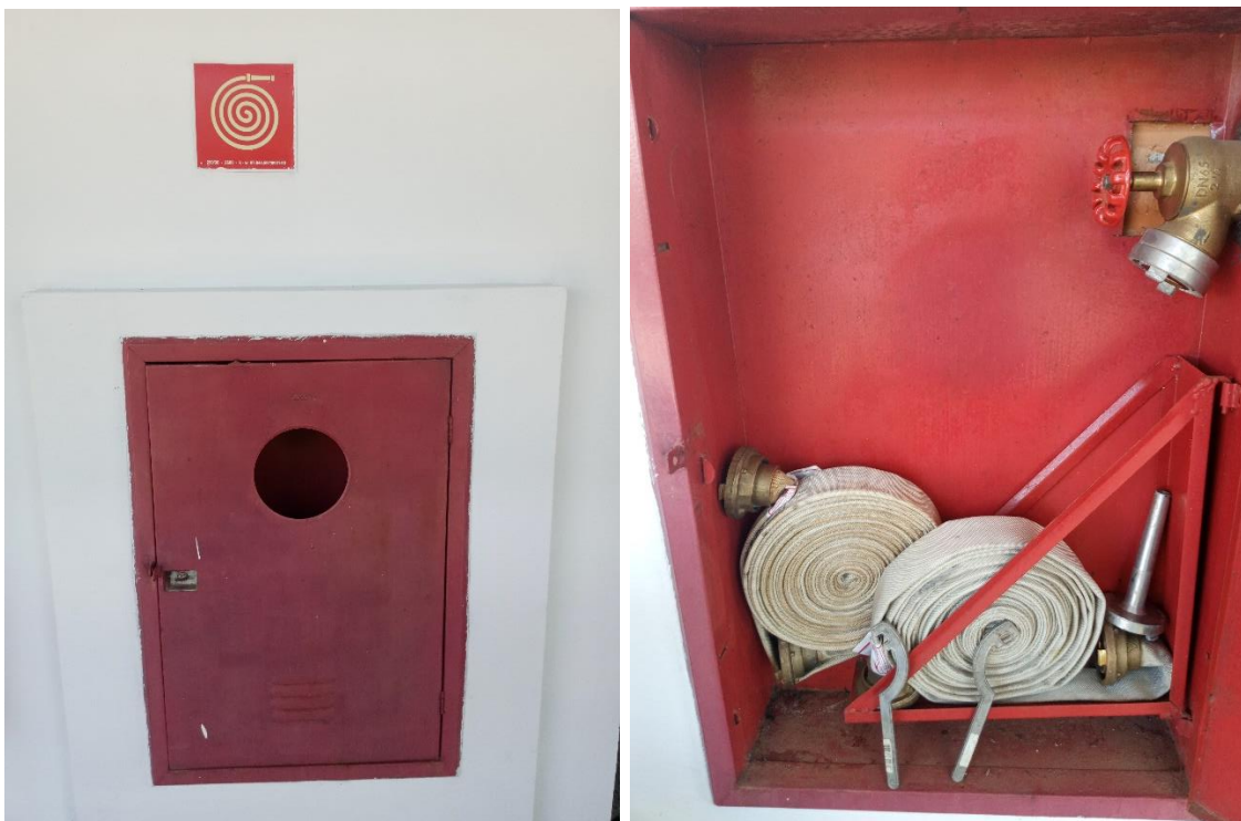
Figura 6-22 – Hidrante Superior II
