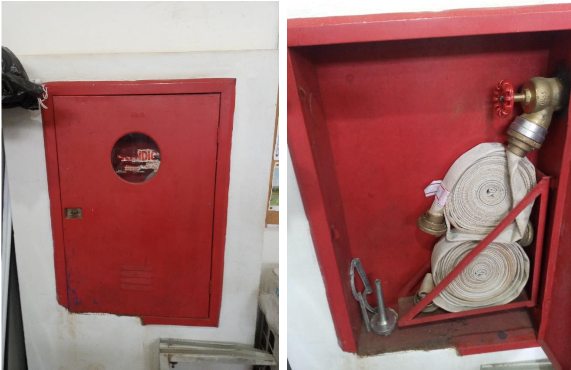
Figura 6-19 – Hidrante do Sala Administrativa
