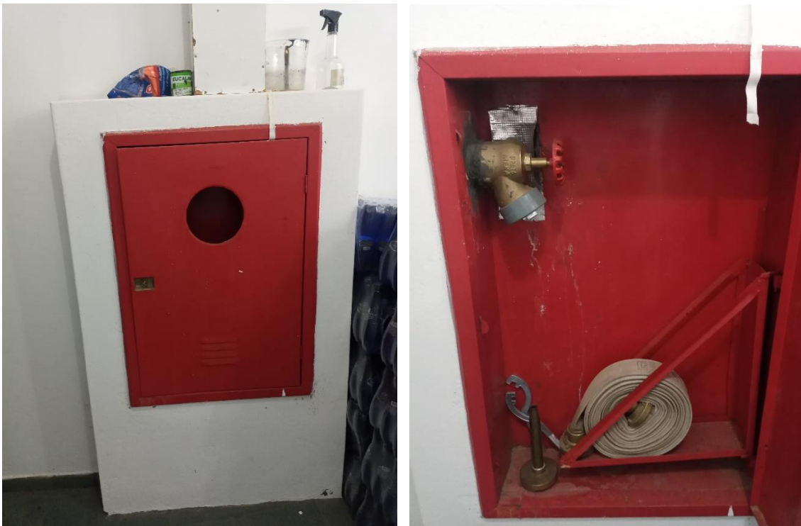
Figura 6-14 – Hidrante da Enfermaria
