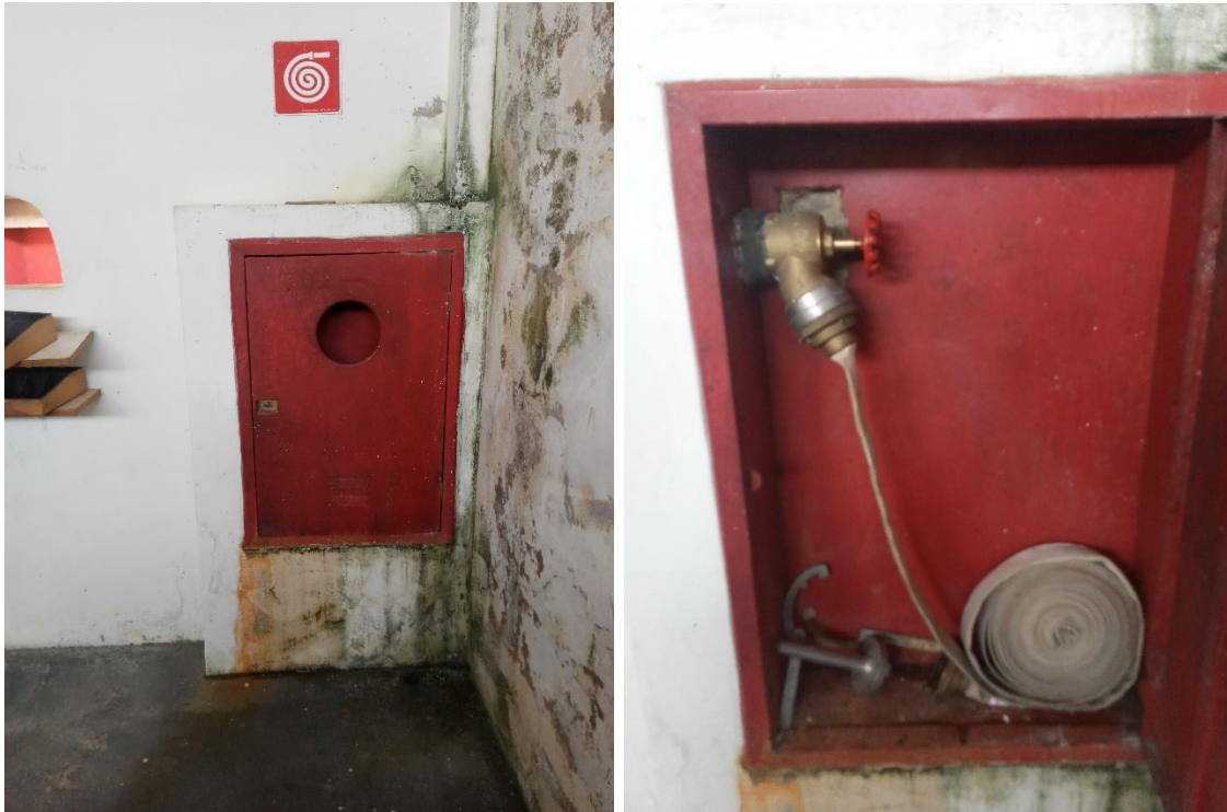
Figura 6-15 – Hidrante do caixa da Lanchonete I
