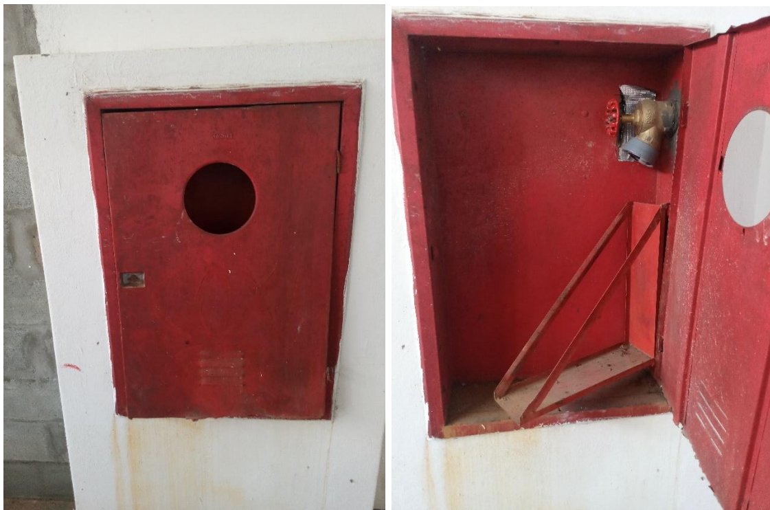
Figura 6-20 – Hidrante do Depósito de lixo
