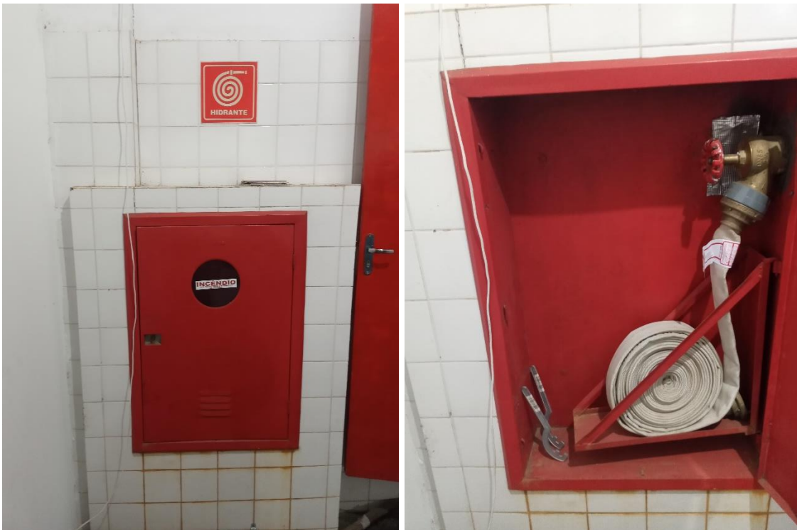
Figura 6-12 – Hidrante do Vestiário dos árbitros
