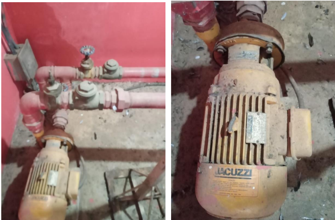
Figura 6-24 – Bomba de incêndio existente
