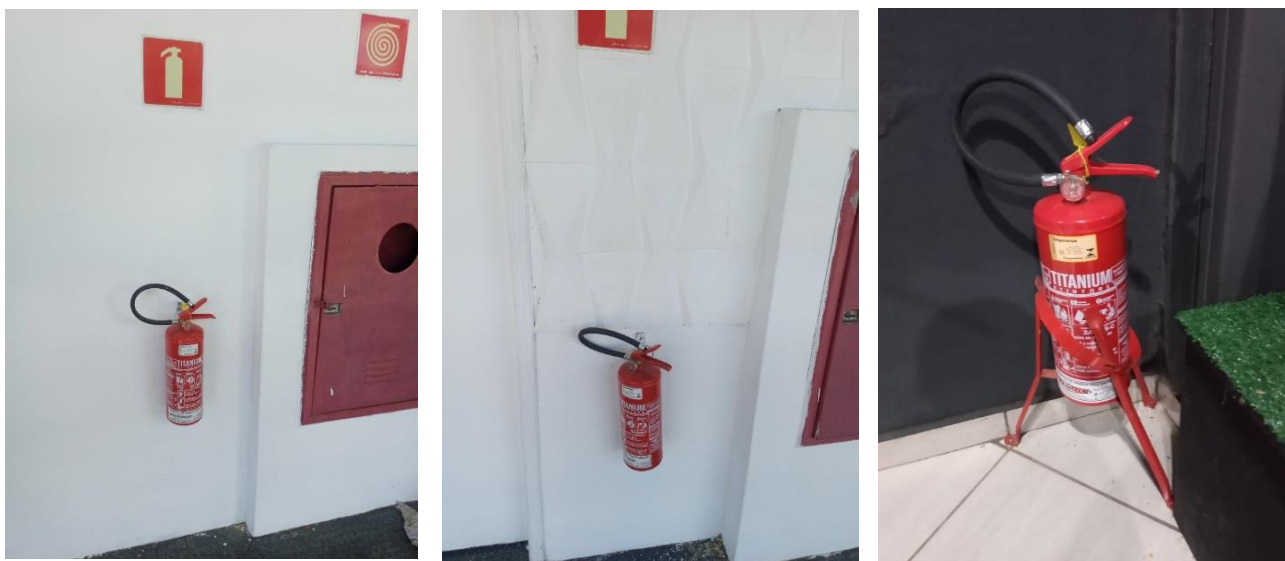
Figura 6-7 – Extintores instalados incorretamente
