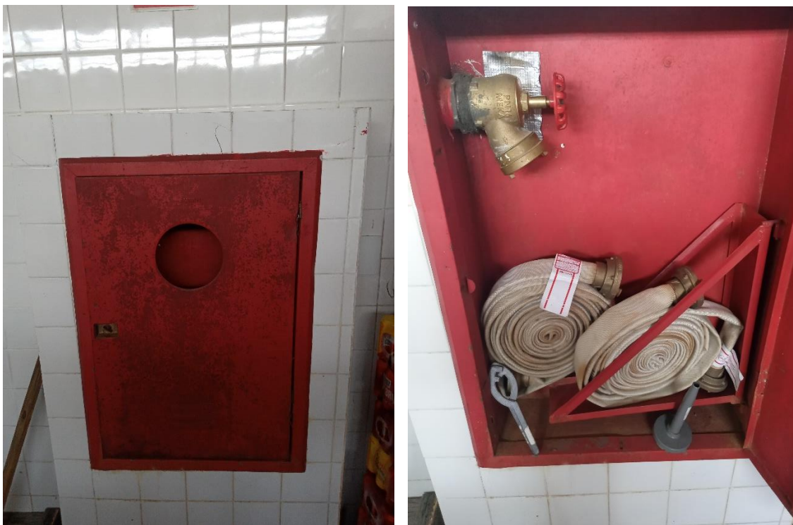
Figura 6-16 – Hidrante do caixa da Lanchonete I
