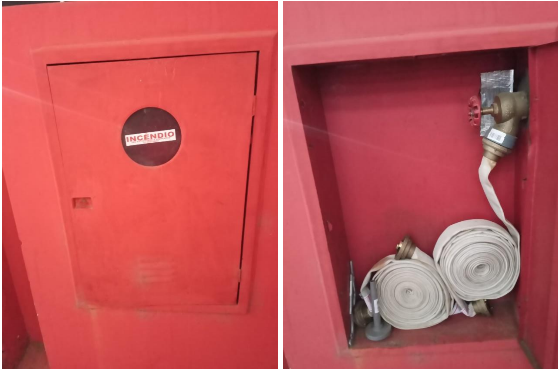
Figura 6-11 – Hidrante do Vestiário II
