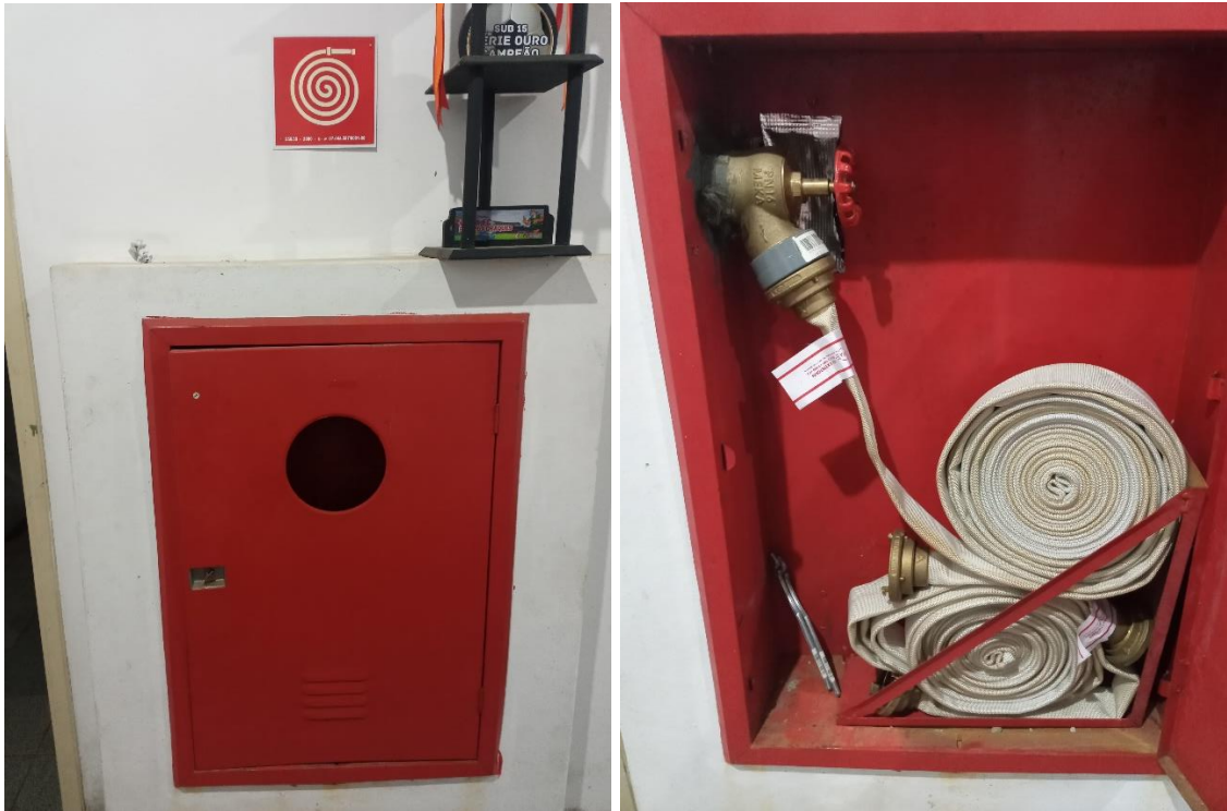
Figura 6-13 – Hidrante da Administração
