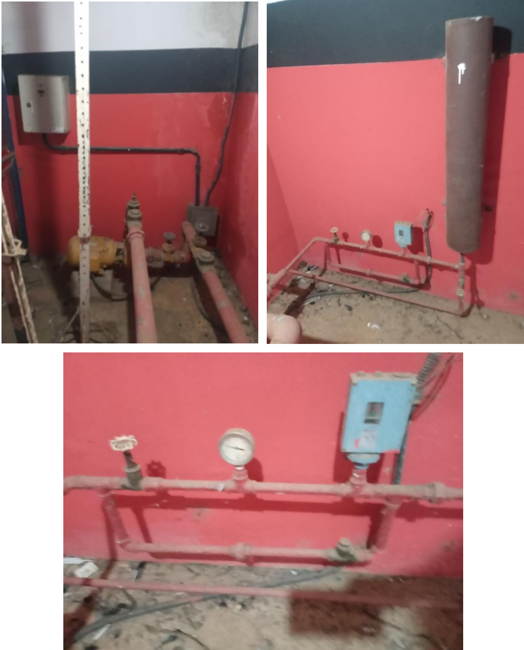
Figura 4-3 – Dispositivos da casa de máquinas
