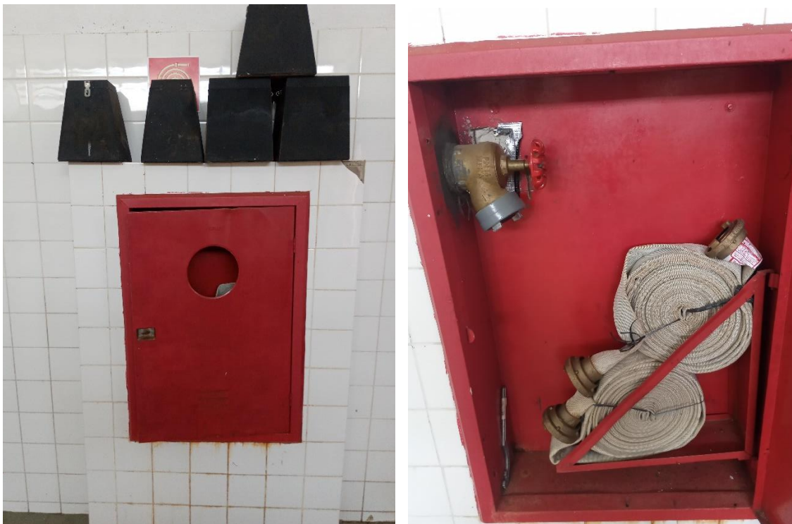
Figura 6-18 – Hidrante do da Lanchonete II
