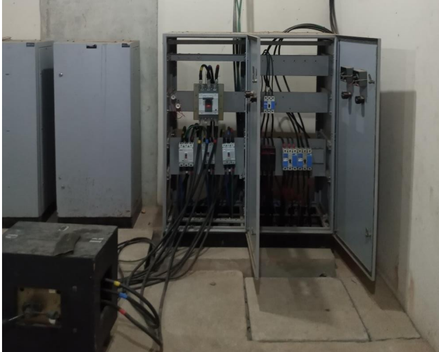
Figura 6-3 – Conjunto moto gerador da edificação
